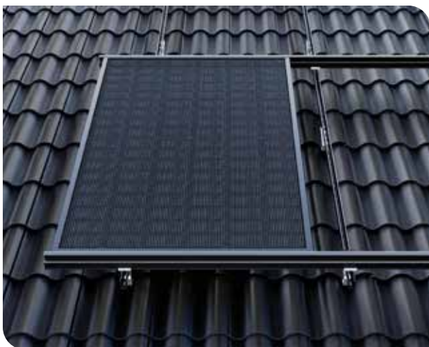
Fertig eingesetztes Solarmodul
